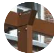
🔍 Pillar beam junction Nodo trave pilastro Nœud poutre pilier Verbindungsknoten von Balken/Pfeiler Nudo viga columna Verbinding balk staander
